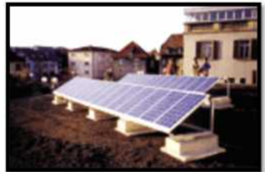
Figure 12 : les panneaux solaire .
