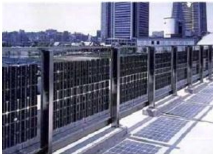
Fig.32. garde corps pour terrasse et balcon Bonne intégration visible.
