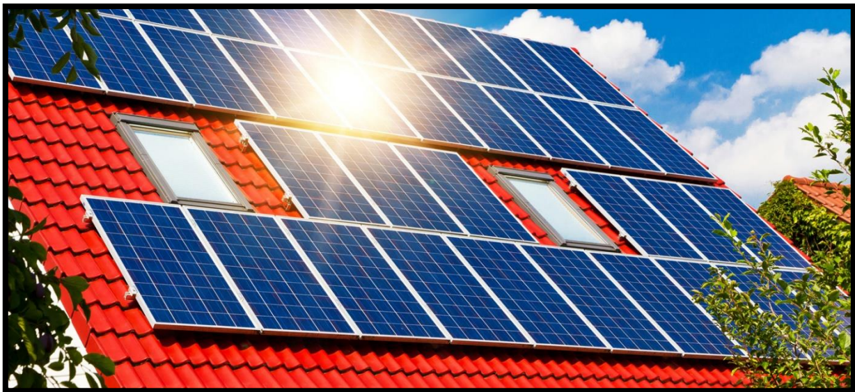
Figure 5. Les panneaux photovoltaïques Source : www.bsolar.ma
