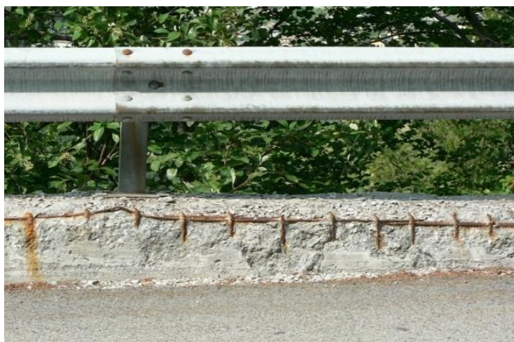
Figure I-13 : Action du gel dans les fissures du béton [15]
