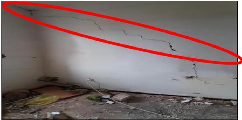
Figure IV-5 : Dégradation du béton
