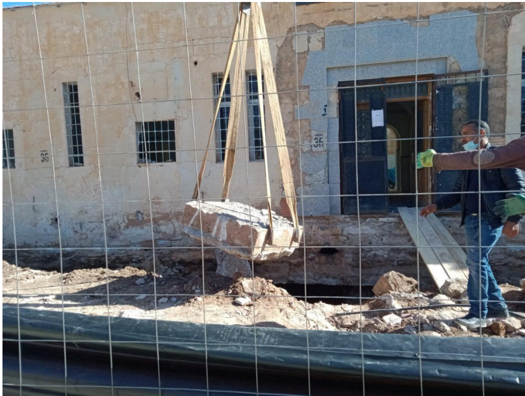
Figure IV-18 : les semelles dégradées
