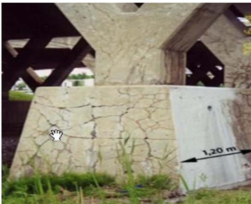
Figure I-4: Exemple de béton dégradé
