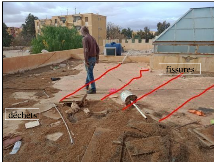
Figure IV-11 : L'état global de l'étanchéité terrasse
