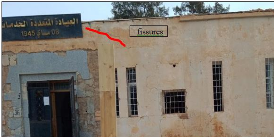
Figure IV-9 : fissure au niveau de l'acrotère.
