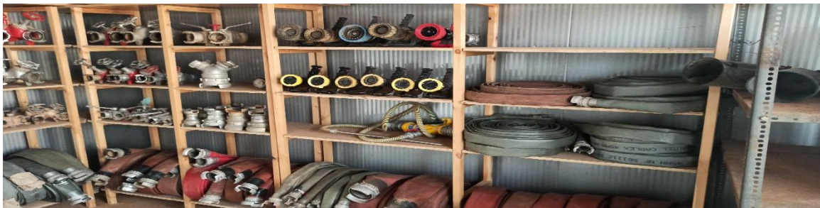
Figure 36 : Les accessoires de lutte contre l'incendie
