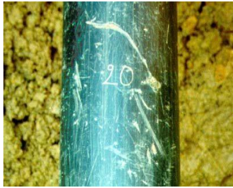
Figure I.13: Défectuosité du revêtement ( 15 \times 20 \text{ mm} ) sur la génératrice supérieure de la canalisation, la dimension du trou dans le revêtement est de quelques \text{mm}^2 [10].
