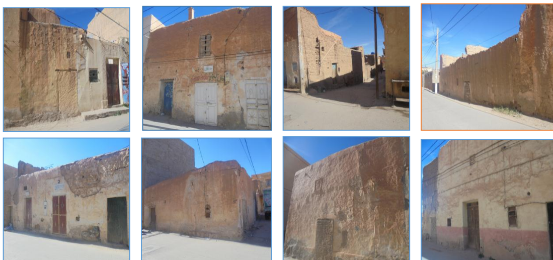
Figure 105.III : les façades qui nécessitent des travaux d'urgence ; prise par les étudiantes
