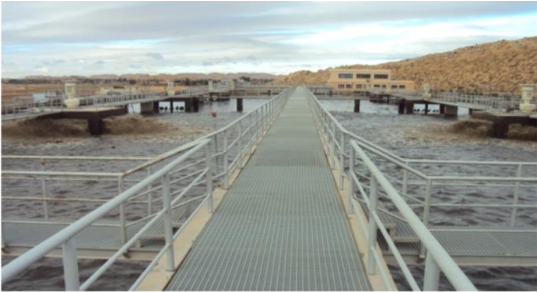
Figure 7: Le traitement biologique STEP de Laghouat ( Photo originale, 2018 ).
