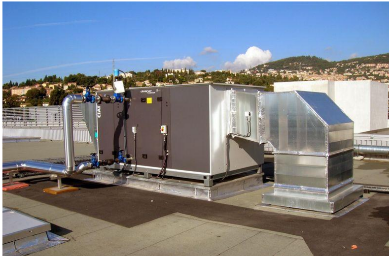
Fig V.42 : centrale de climatisation / source :Bâtiment du futur .N°69
