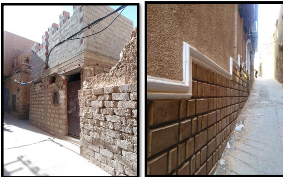
Figure N°77 : L'état actuel des façades. Source : Auteur.
