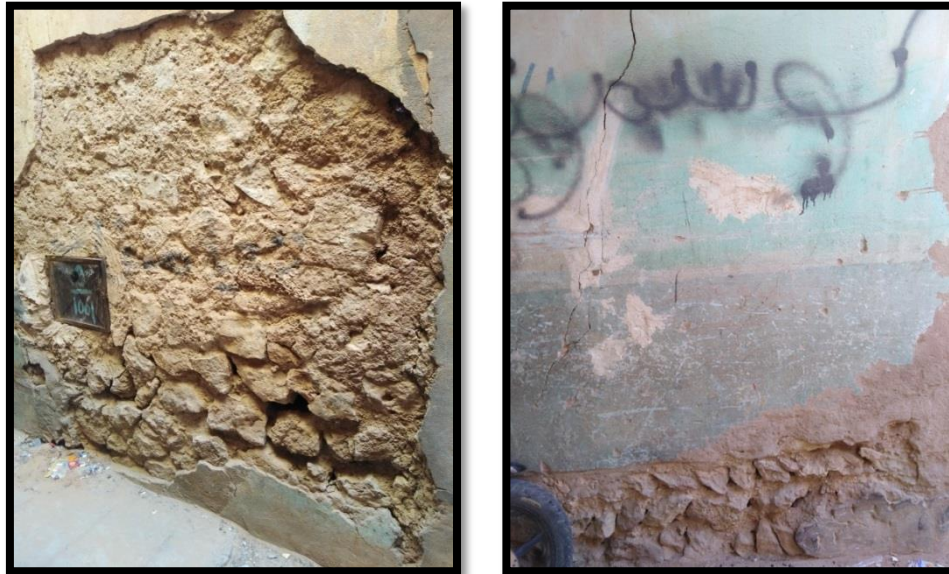
Figure N°76 : L'état actuel de quelque maison. Source : Auteur.
