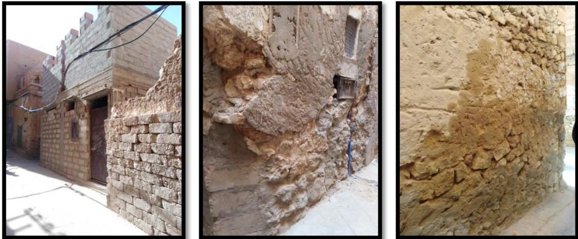
Figure 2 : Dégradation du cadre bâti du ksar de Berriane [auteur].
