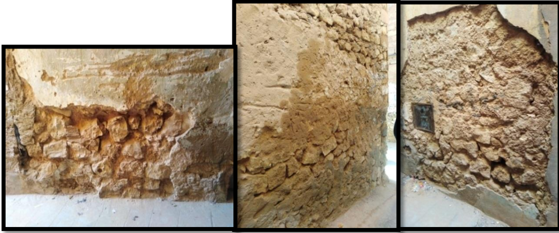
Figure N°90 : L'état de lieu de quelques maisons à démolir. Source : Auteur.
