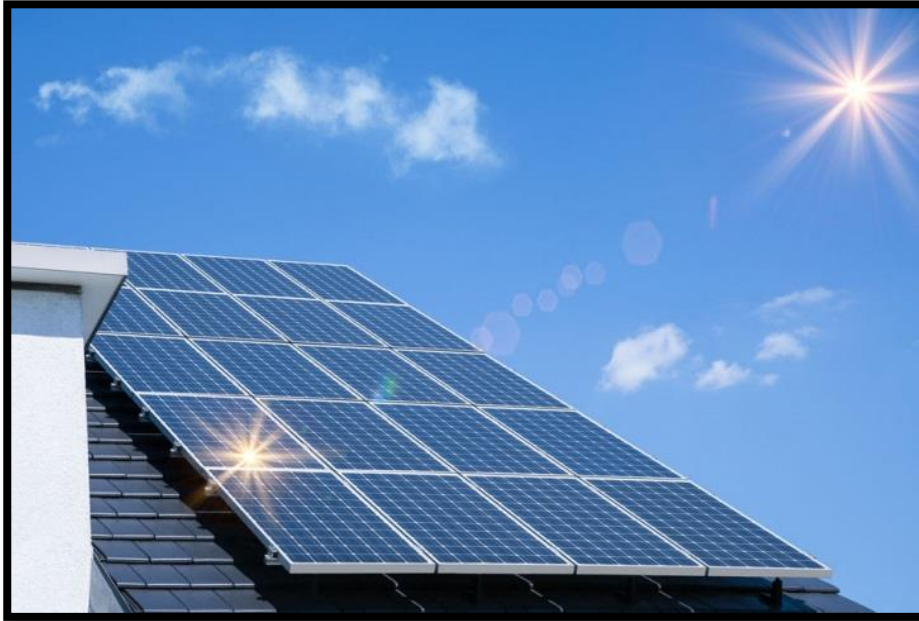
Figure N°118 : Les panneaux solaires. Source : http://mozaikwebradio.com
