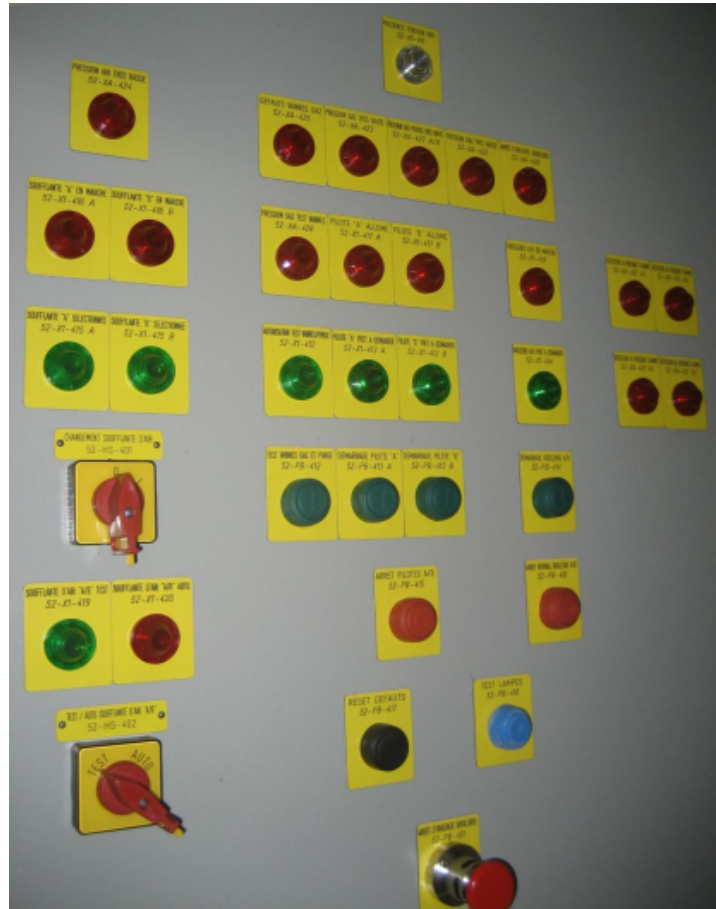
FIGURE 2.7 – Tableau local de démarrage et d’arrêt des brûleurs .
