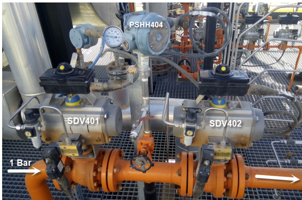
FIGURE 2.9 – Circuit du gaz principal des brûleurs.
