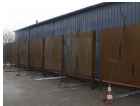
Figure 108: Tôles en voie de développement de la corrosion superficielle
