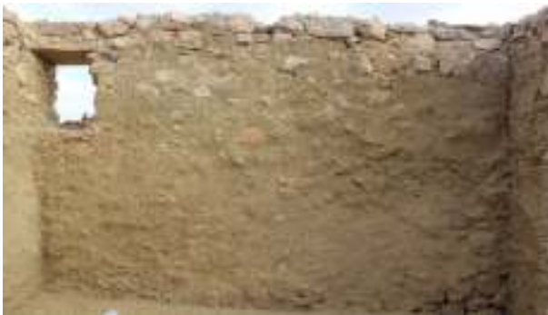
Figure 86 : L'effritement du mortier
