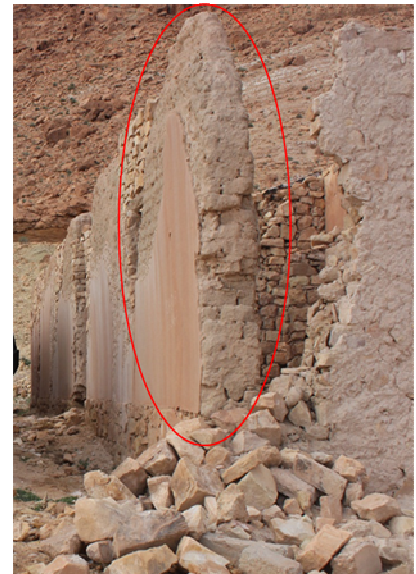
Figure 85 : L'effritement du mortier
