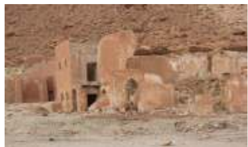
Figure 79 : la dégradation totale des toits du palais
