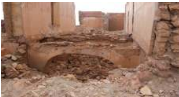
Figure 81 : L'effondrement des toits
