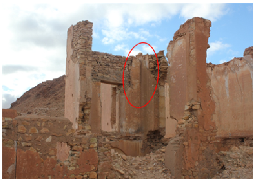
Figure 83 : Les fissurations principales
