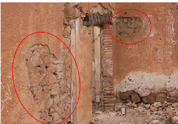
Figure 87 : La perte du crépissage des murs
