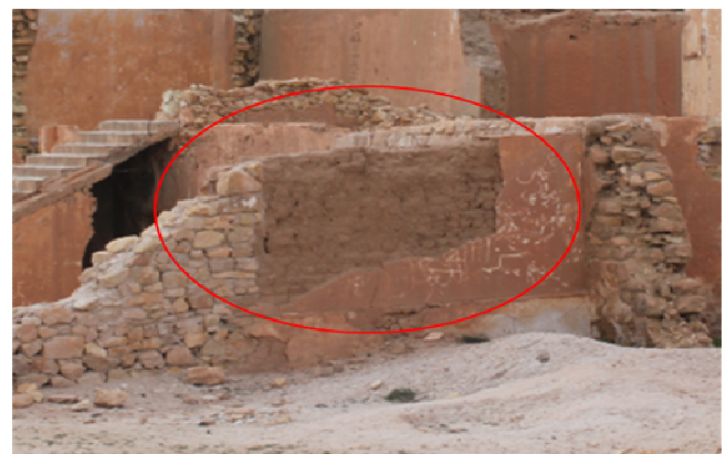
Figure 88 : La perte du crépissage des murs
