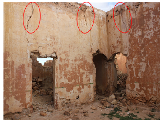
Figure 82 : Les fissurations secondaires
