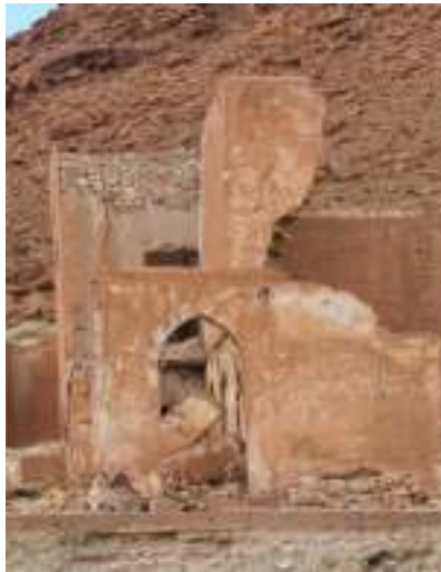
Figure 89 : Les renflements dans les murs
