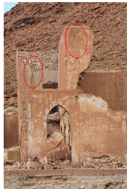
Figure 84 : Fissurations en lézard
