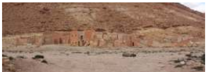
Figure 77 : Vue générale montrant l'état de dégradation du palais
