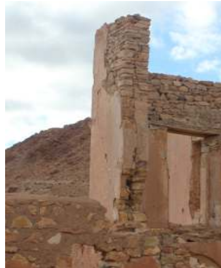
Figure 90 : Les renflements dans les murs
