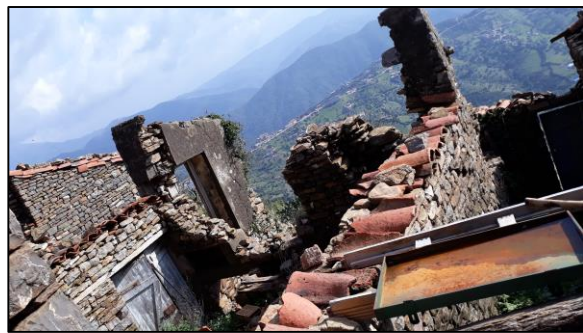
Figure 111 : une maison en ruine dans le village
