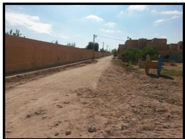
Photo 34 : la dégradation des voies Source : auteur
