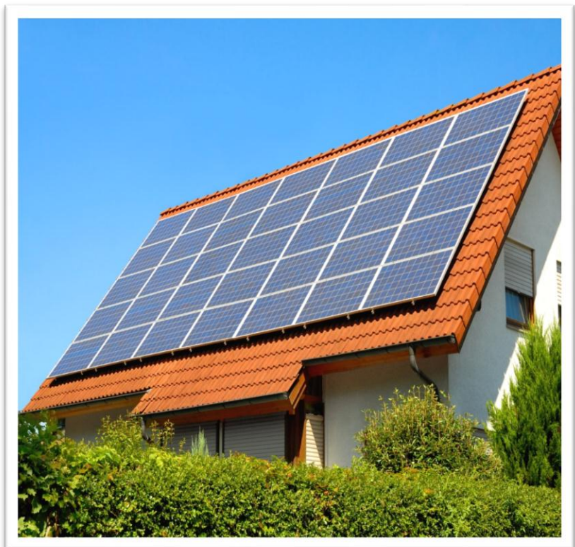
Image 1 : photo des panneaux solaire
