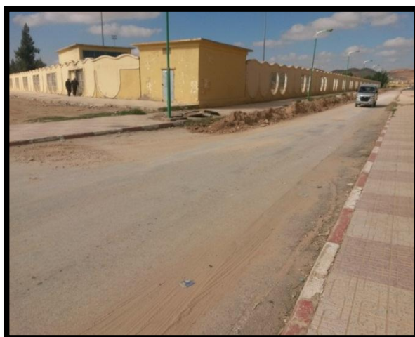
Photo 33 : la dégradation des voies Source : auteur
