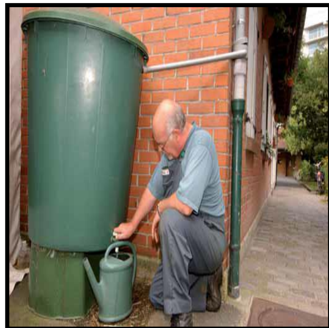
Photo 63: représente l'utilisation des eaux récupéré
