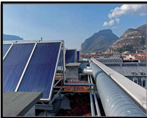
Photo 24: panneaux solaire Source : La ZAC de Bonne à Grenoble/Collection images
