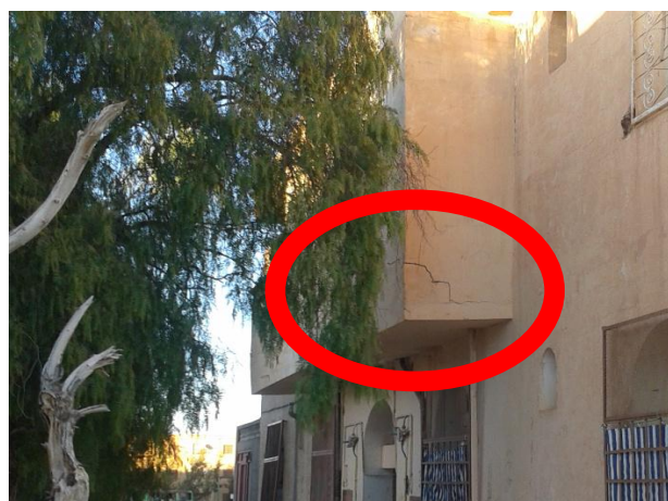
Photo 36: la dégradation de logement Source : auteur
