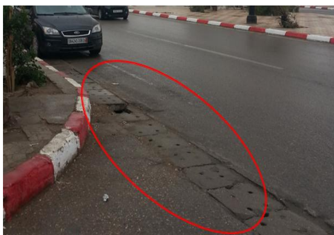
Photo 25: les eaux pluviales dans la ville de Laghouat Source : auteur
