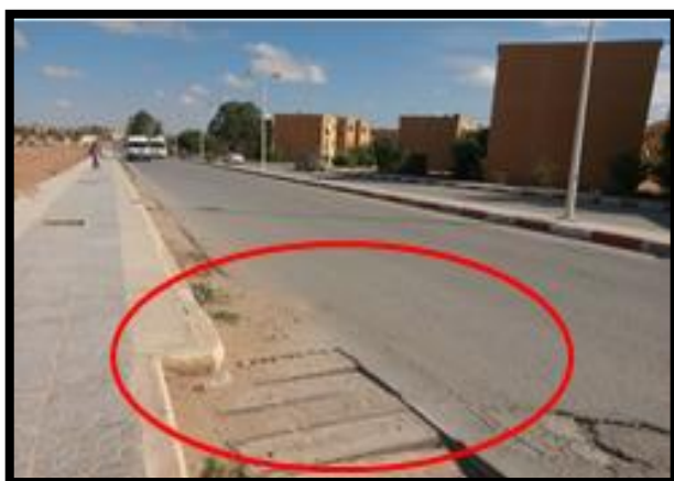
Photo 42: la dégradation de trottoir Source : auteur
