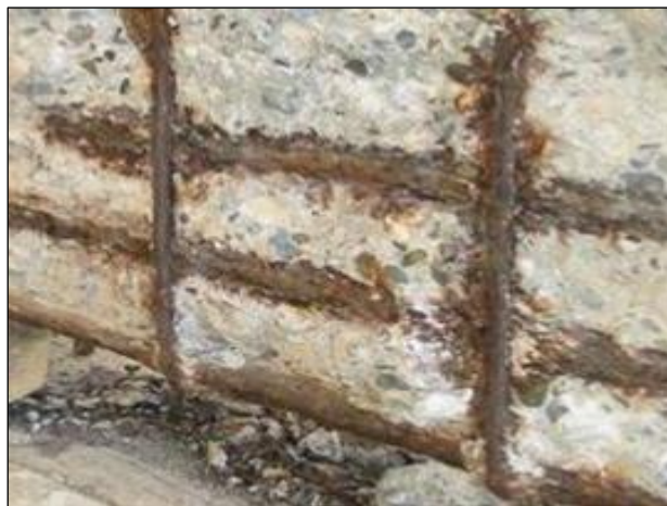
Figure 2.11: Corrosion de l'acier d'armature.
