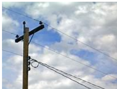
Fig.I.2. Lignes électriques aériennes
