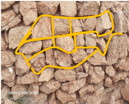
الصورة 73: تأكل فواصل الملاط
