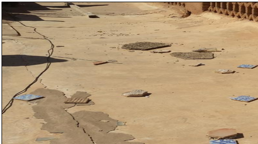
Figure III.4. Fissure sur le plancher terrasse.
