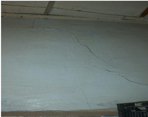
Figure III.20. Des fissures superficielles au niveau du plancher et murs porteurs
