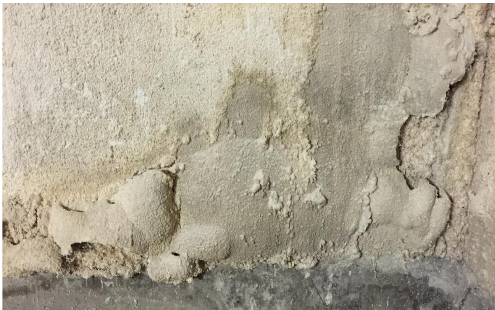
Figure II.5 : Humidité Sur Mur [24]
