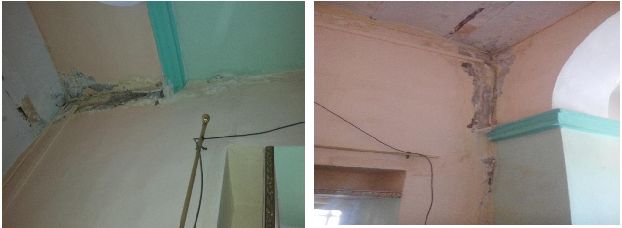
Figure III.22. Présence de l'humidité
