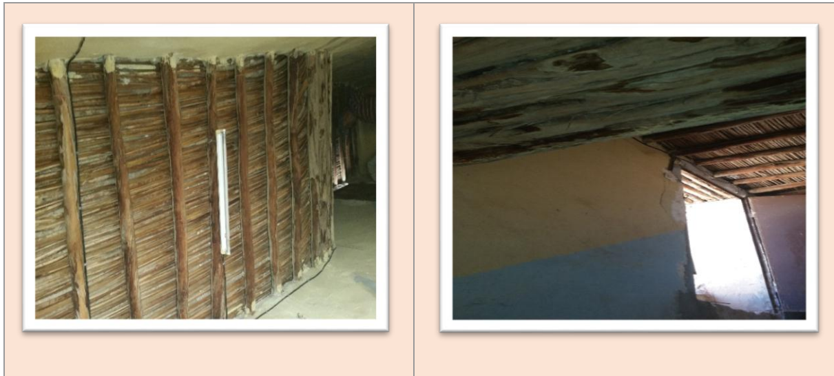
Figure III.16. Pathologie sur les planchers
