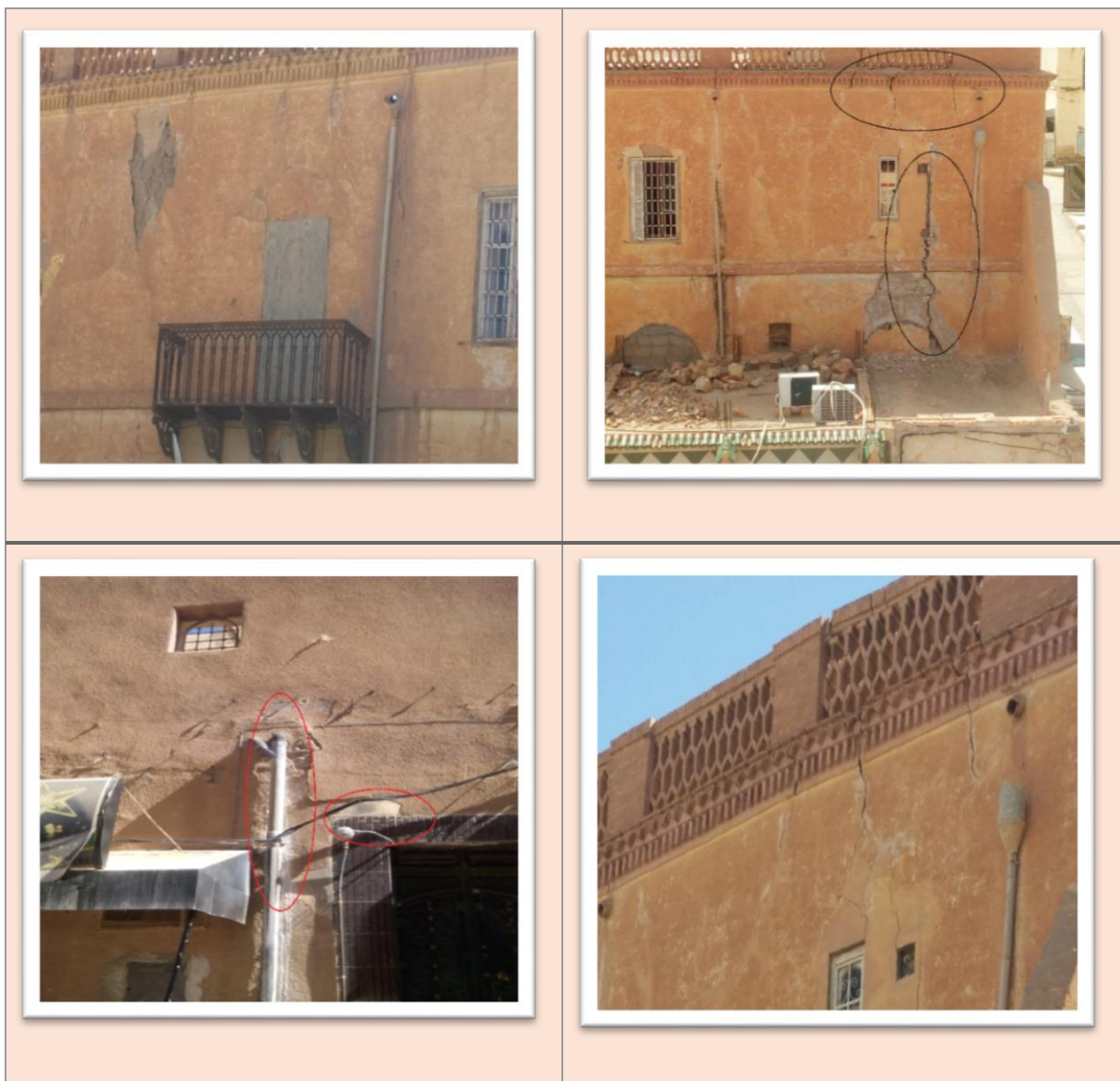
Figure III.15. Pathologie sur les façades.
