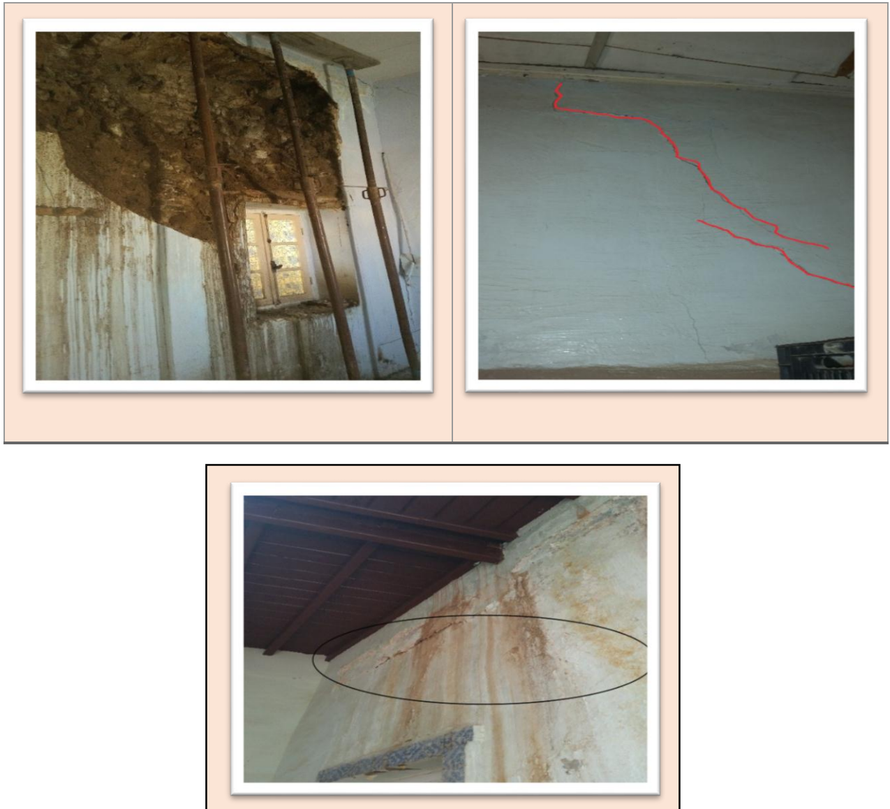
Figure III.14. Pathologie sur les murs.
