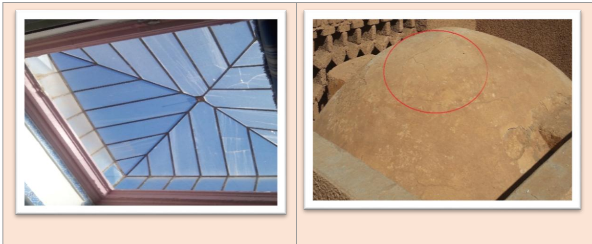
Figure III.17. Pathologie sur le Terrasse
