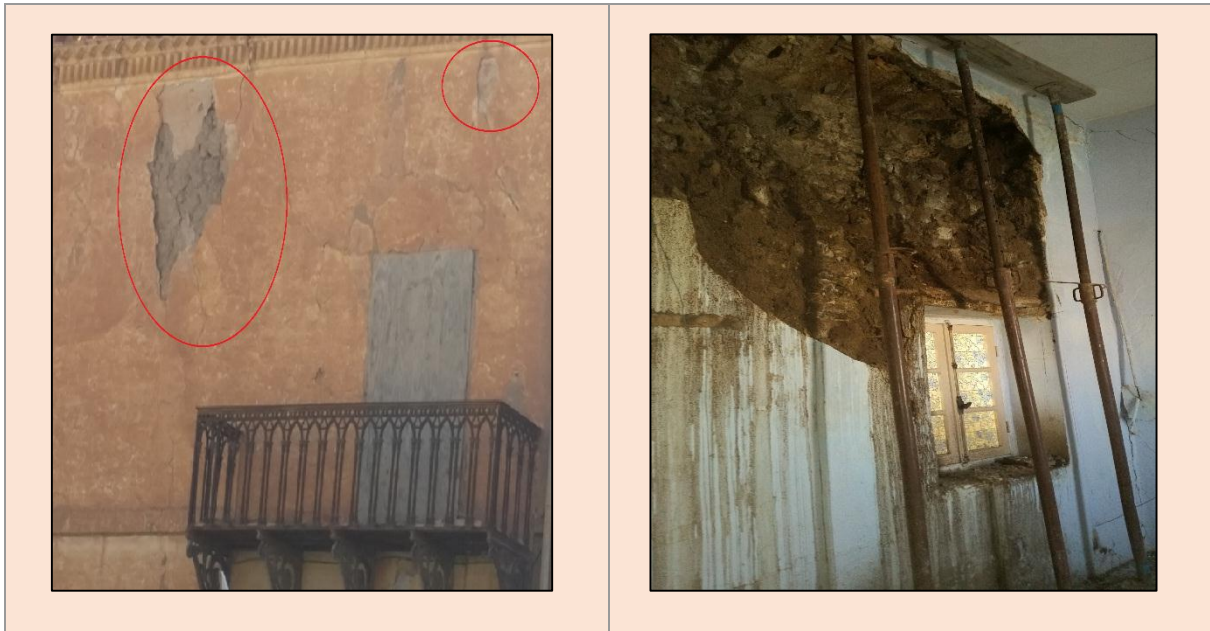
Figure III.3. Décèlement des murs intérieur et extérieure et dégradation d'enduit.
