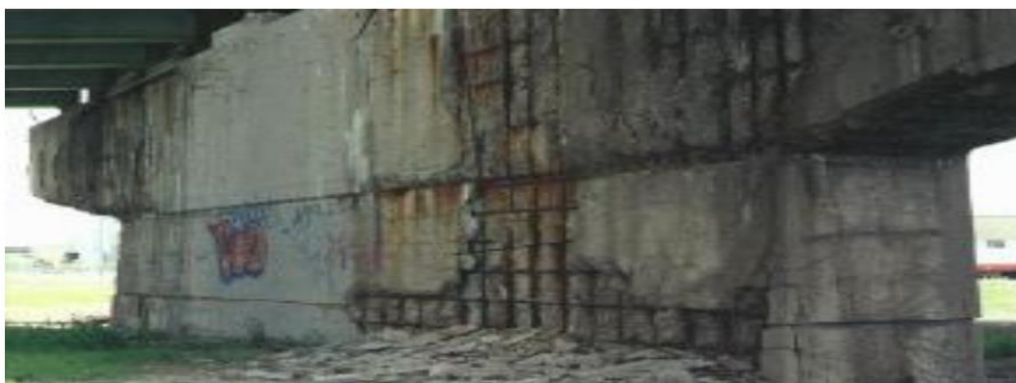
Figure 1.2 Influence de la corrosion des armatures dans la structure [14].
