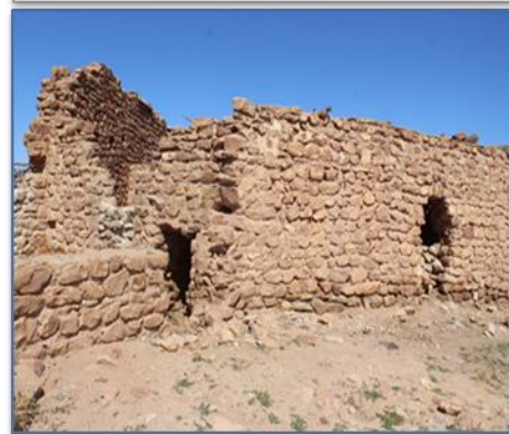
Effondrement des parties exterieurs
