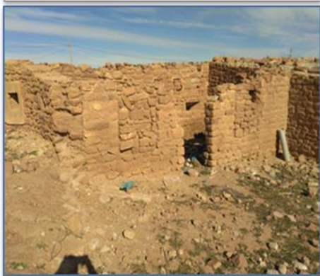
Effondrement des parties interieurs
