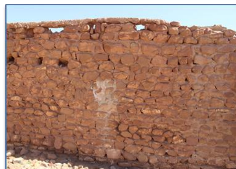
Fissuration principale profonde
