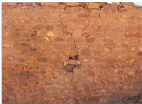
Fissuration principale profonde
