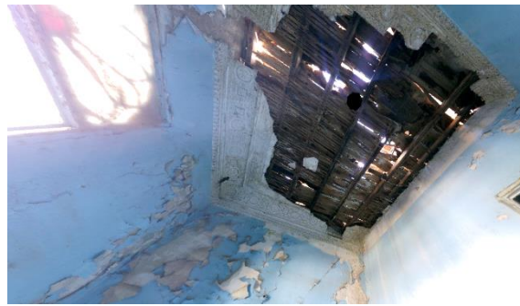
Figure 74 : Pourrissement du bois, source : scanner BLK360 Sahli
