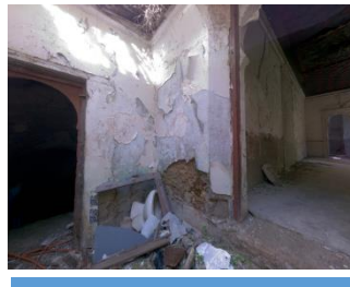
Décollement et effritement de l'enduit en 1 er étage +3.05
