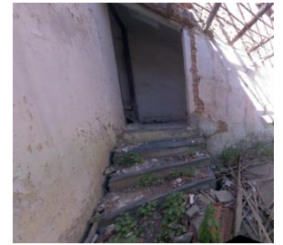
Fissure de mur en 2 ème étage +5.85
