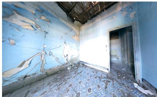
Figure 70 : Décollement des enduits des murs intérieurs, source : scanner BLK360 Sahli
