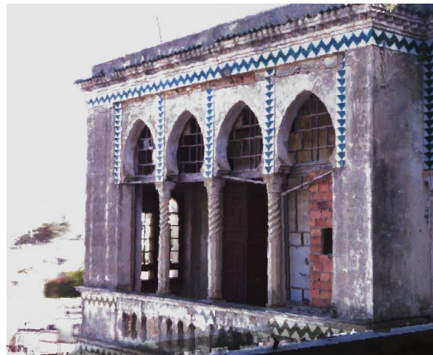
Figure 48 : Arc outrepassé brisé, Palais des Aveugles. Source : scanner BLK360 Sahli
