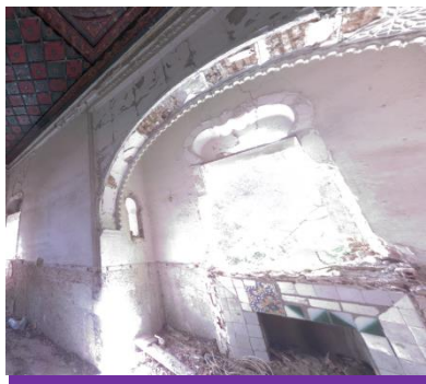
Décollement des parties de revêtement des murs en 2 ème étage +3.5
