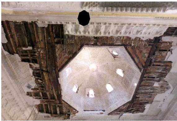
Figure 73: Corrosion de l'acier, source : scanner BLK360 Sahli
