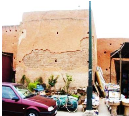
Figure 13: décollement d'enduit, source : la restauration de muraille de Marrakech.pdf
