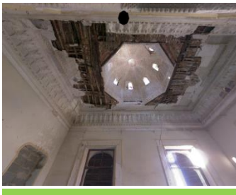
Corrosion de l'acier du plancher du 2 ème étage +8.10
