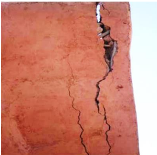
Figure 12: fissures, source : la restauration de muraille de Marrakech.pdf
