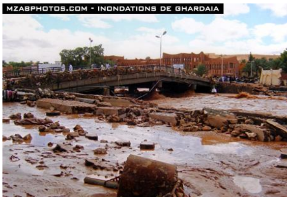
5-Destruction d'un pont
