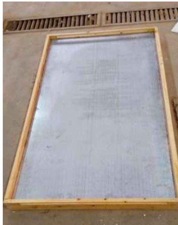
Figure II.18 : Le cadre inferieur de l'absorbeur après l'addition d'une plaque de polystyrène= 40mm + plaque MDF e=2.5mm + Tôle galvanisée e=1.5 mm
