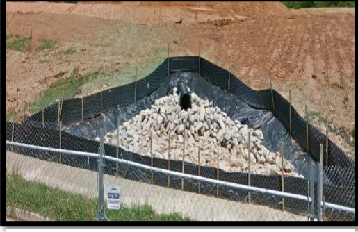
الشكل ا. 19 : احواض لجمع مياه الامطار
