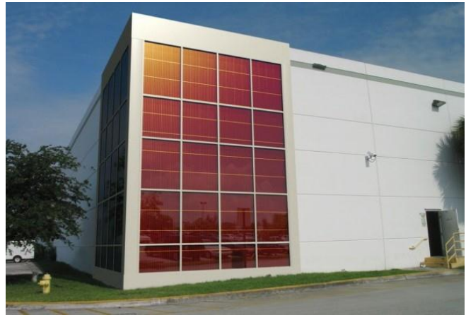
Figure V-23: panneaux photovoltaïque intégré.
