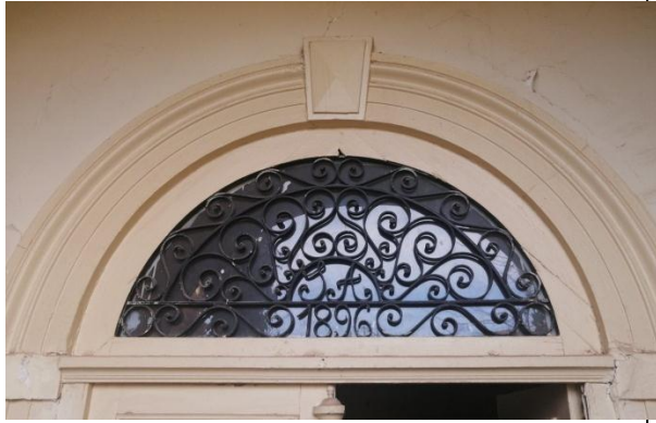
Figure 156: La partie supérieure de la portée d'entrée est décorée en fer forgé, on notera que les éléments constituant ce décor ne sont soudés mais vissés les uns aux autres.
