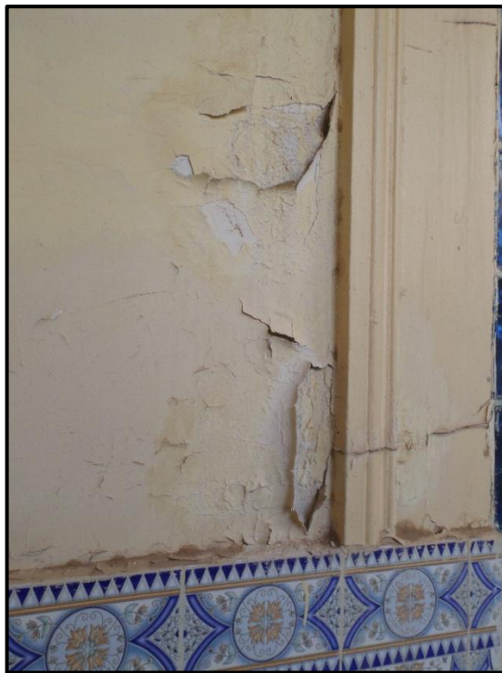
Figure 164: décollement de la peinture au niveau des murs, source: auteur.
