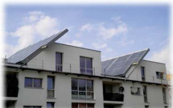
Photo 17: les panneaux photovoltaïques
