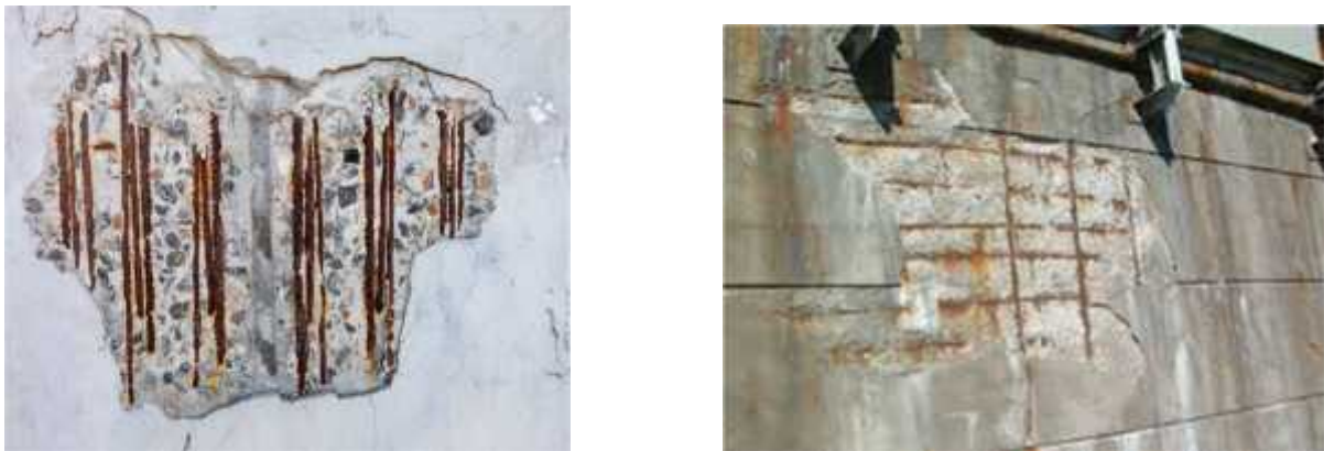
Figure 1 Corrosion des armatures en acier.
