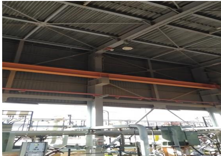
Figure II.7: Détecteur de flamme pour les pompe de gaz ( Hassi r'mel module 4) [11]
