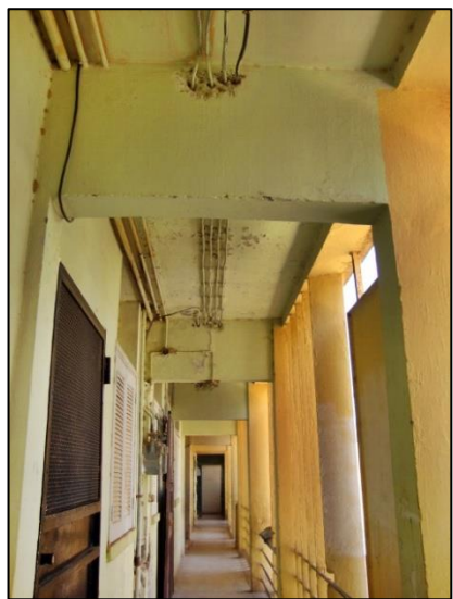
Fig III. 57. Enduit dans le coursive du bloc D
