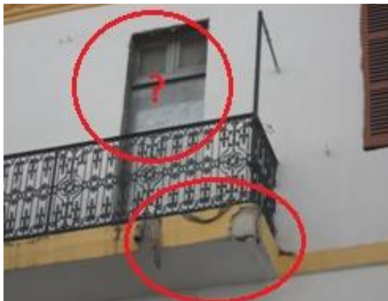
Fig.II. 27: La dégradation rapide des balcons après l'opération
