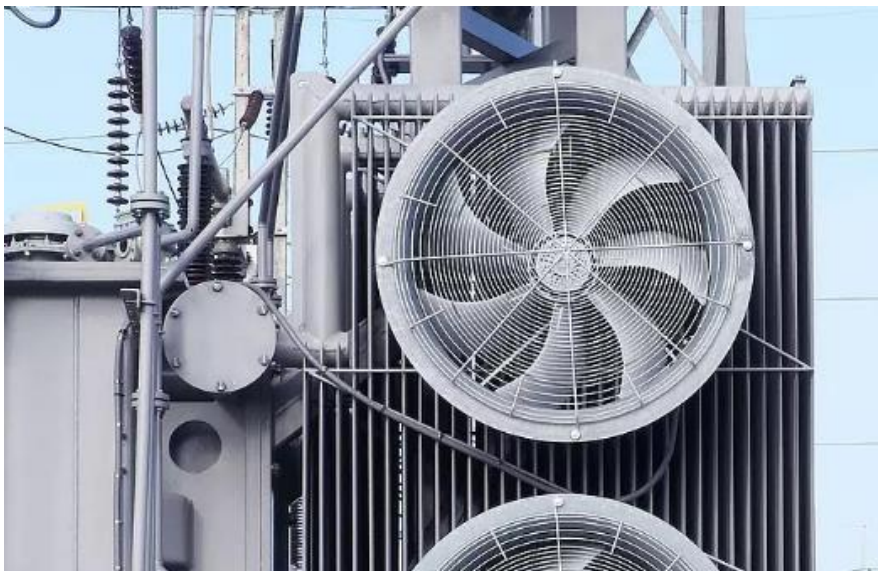
Figure I.4 : Ventilateur industriel de refroidissement
