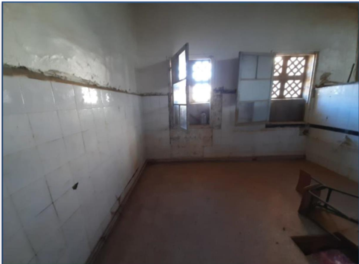
Figure II.30 : Décollement de revêtement mural (faïence). [44]
