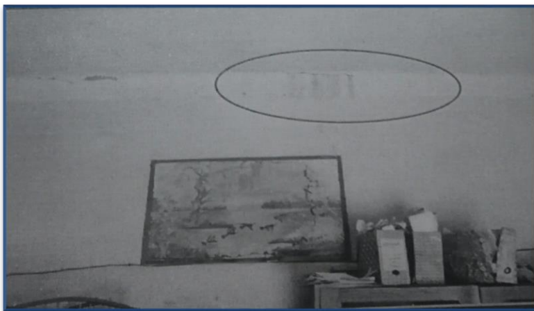
Figure II.24 : Trace d'humidité et d'infiltrations d'eau. [44]
