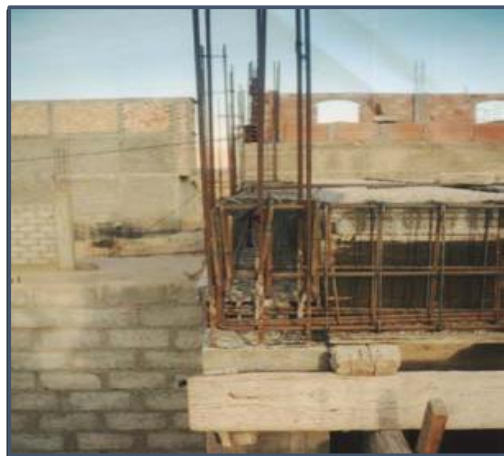
Figure I. 22 : Absence d'armatures transversales au niveau du nœud (poteau- poutre). [10]
