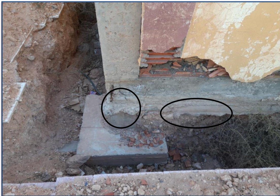
Figure II.23 : Fissures sur les longrines [44]
