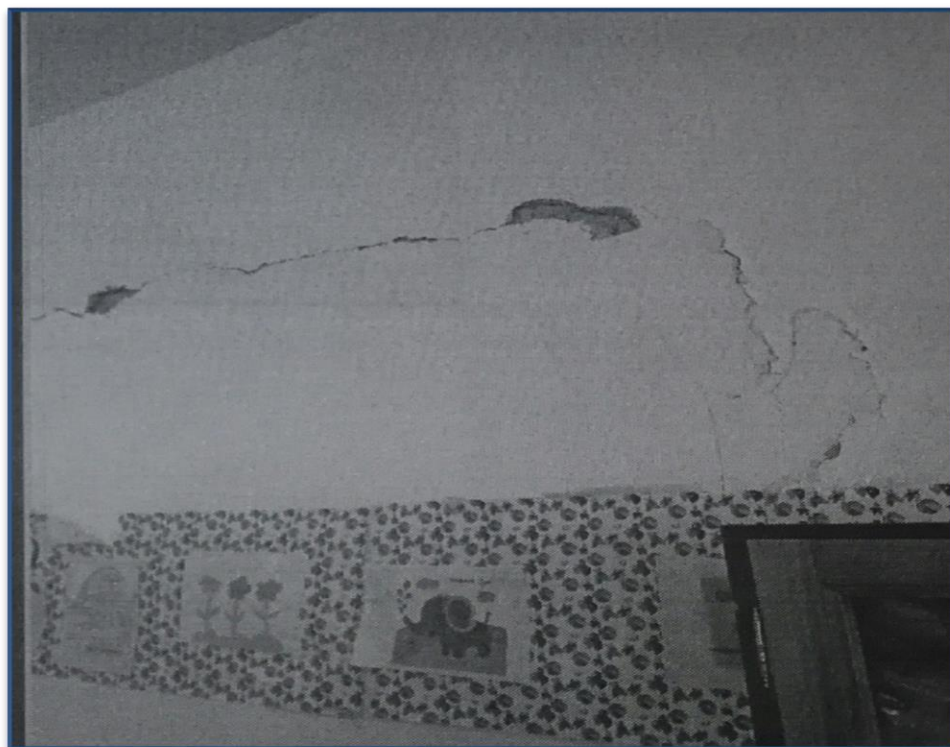
Figure II.20 : Fissures horizontales et verticales sur les murs [44]
