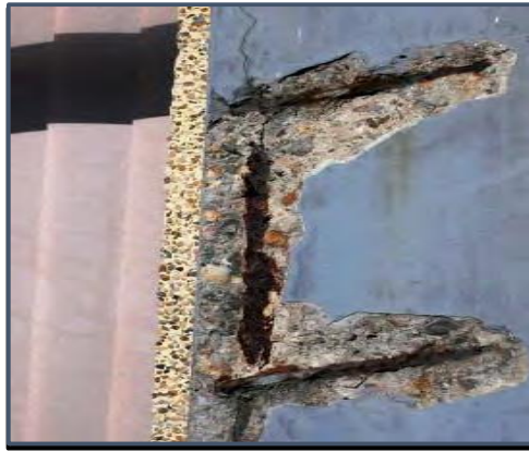
Figure I. 23 : Eclat de béton autour de l'armature d'un poteau insuffisamment enrobée. [17]
