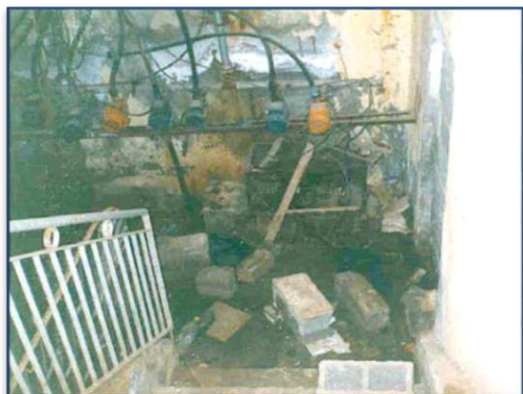
Figure I.26 : La stagnation des eaux dans les caves
