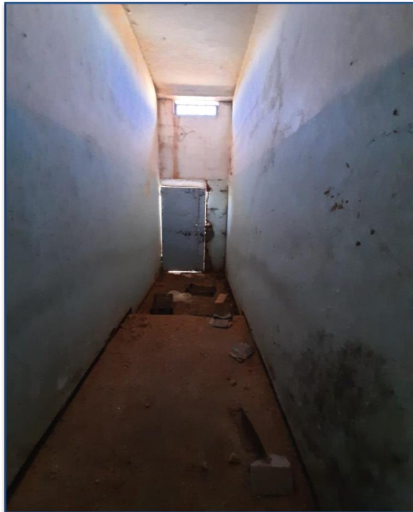
Figure II.25 : Empreinte d'humidité sur les murs. [44]
