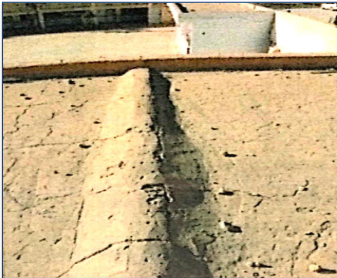
Figure II.26 : Mauvais état de l'étanchéité (terrasse) [44]
