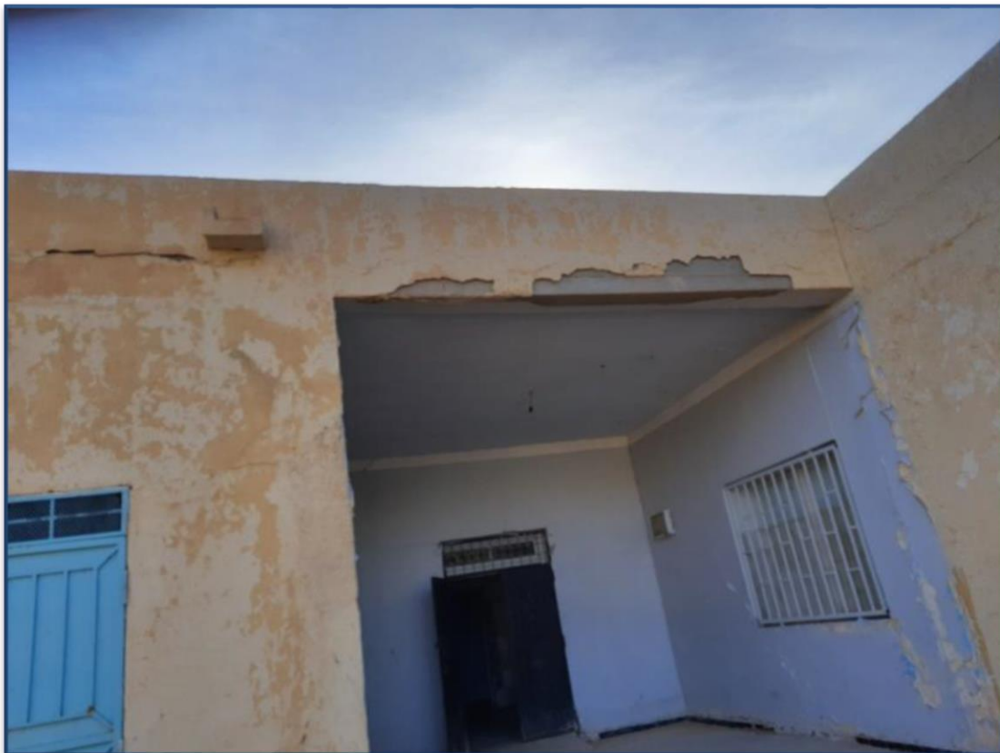
Figure II.27 : Décollement des enduits sur mur extérieur [44]
