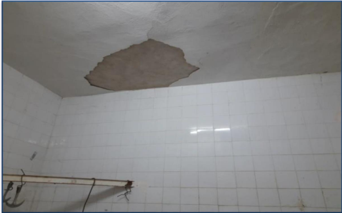
Figure II.29 : Décollement des enduits sur plafond [44]
