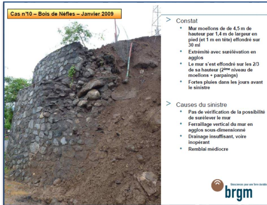
Figure I.15 : Effondrement d'une partie de murs de soutènement (constat-causes). [13]
