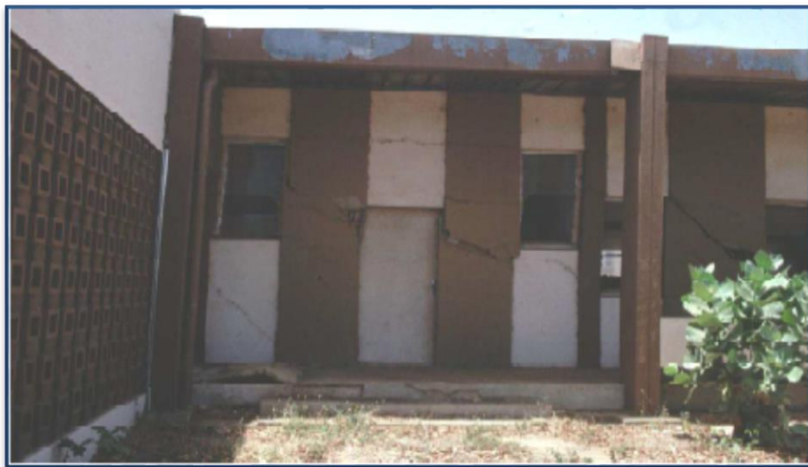
Figure I.8 : Vue des désordres provoqués par des marnes gonflantes. [3]
