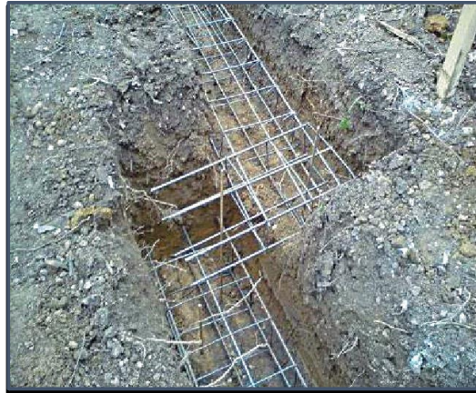
Figure I. 21 : Mauvaise mise en place des ferrailages (défaut de recouvrement, de liens entre ferrailages, attente de liaisons des poteaux). (Source Socabat). [8]
