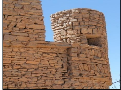
Fig. 46 : La Tour du coté sud-est du Ksar.
