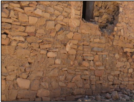
Fig. 96 : Mur illustrant son hétérogénéité. Ksar Taouiala.
