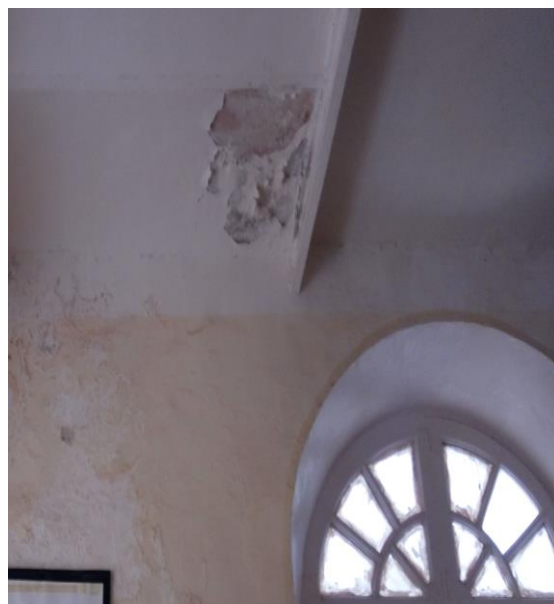
Figure 86 Infiltration des eaux. Source : l'Auteur
