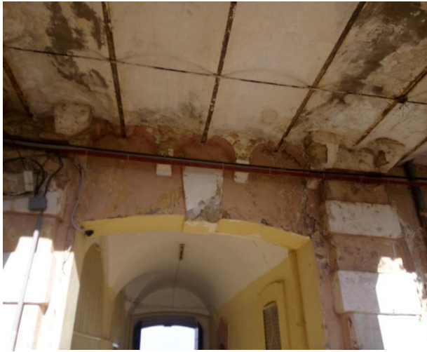
Figure 26: Dégradation des enduits / Formation de salpêtre. Apparence des solives. Source : l'Auteur
