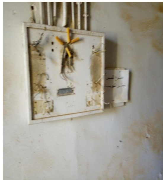
Figure A: Risque de table électrique.
