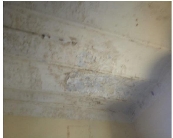
Figure 31: Dégradation des enduits. Source :l'Auteur
