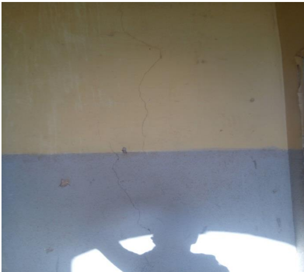
Figure 28: Fissuration superficielle. Source : l'Auteur
