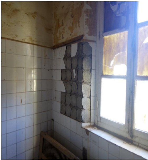
Figure 35: Dégradation des revêtements
