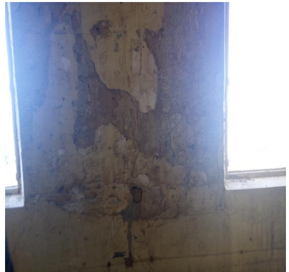
Figure 29: Dégradation des enduits et revêtements. Source : l'Auteur
