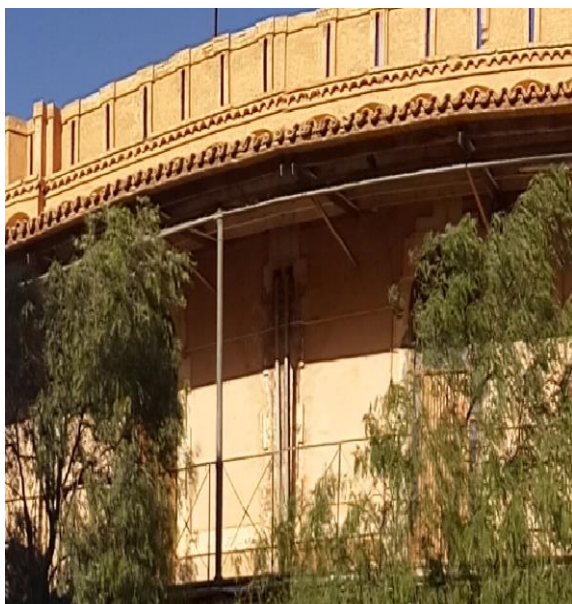
Figure 85 Dégradation des crépissage. Source : l'Auteur
