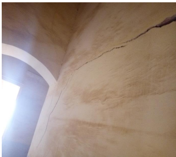
Figure 32: Fissuration superficielle . Source : l'Auteur
