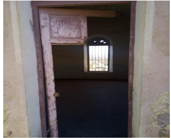
Figure 27: Dégradation des portes. Source :l'Auteur
