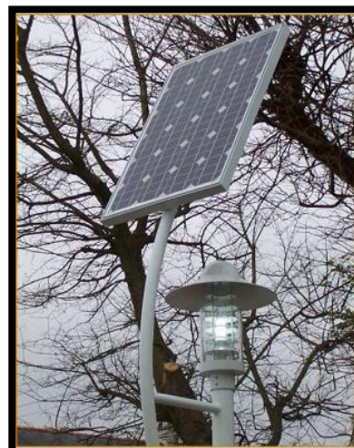
Figure27 : lampadaire solaire /source : document Description lampadaire solaire
