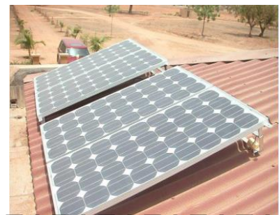
Figure 04: panneau photovoltaïque Source : Doucement les énergies renouvelables dr marwan jarkas
