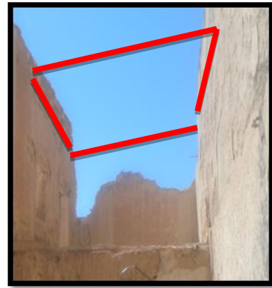
صورة توضح سقوط السقف
