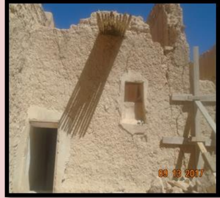
صورة توضح تشقق الجدران
