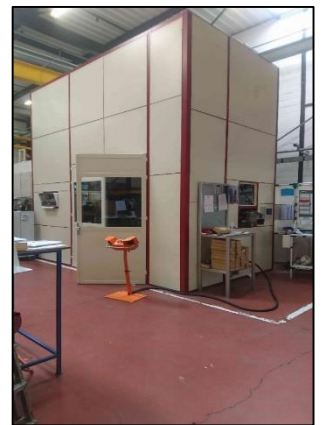
Figure 62 cabine acoustique Source : www.cometac.fr
