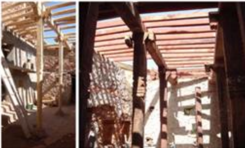
Figure26 : photo représente avant et après les travaux de réhabilitation Source: réhabilitation de la mosquée TimzguidaUkhriben .S.Nadji
