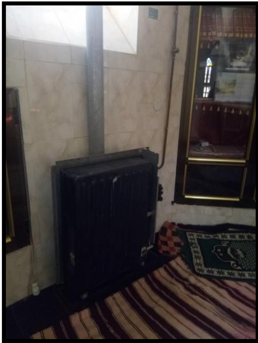
Figure 80: photo de l'un de dispositif de chauffage source:auteur
