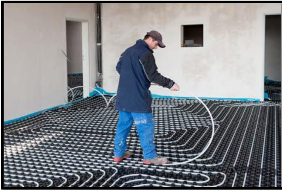
Figure 119: photo représente la pose de la boucle de chauffage Source : LEGUIDE DU PLANCHER CHAUFFANT
