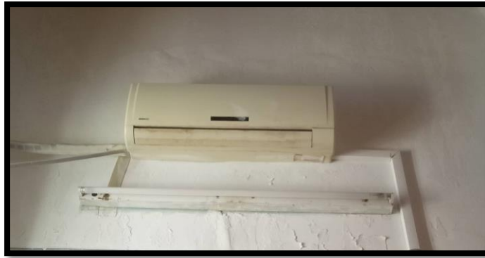
Figure 74: photo d'un climatiseur dans la mosquée Source: auteur
