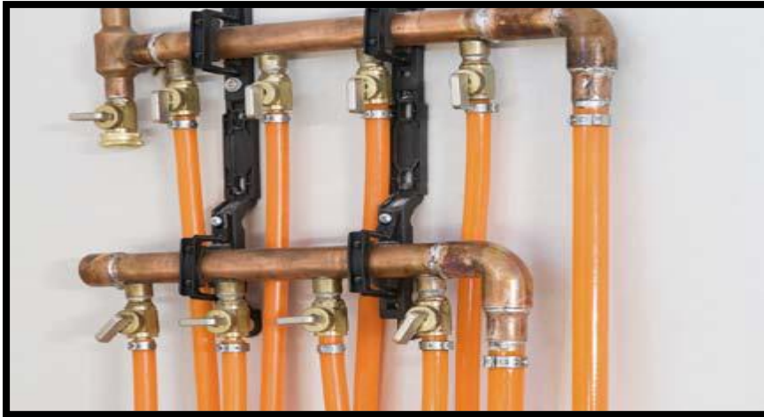
Figure 122: photo de collecteur du plancher chauffant Source: LE GUIDE DU PLANCHER CHAUFFANT
