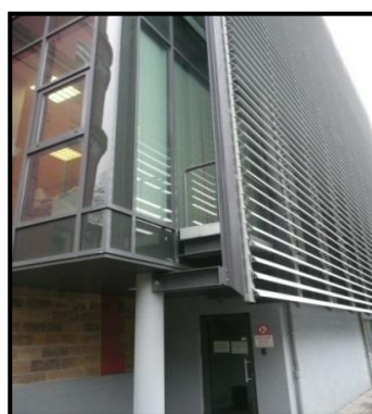
Figure 84 : prise solaire de center anti cancer. Source : équipe A. ZRARGA HOCINE.
