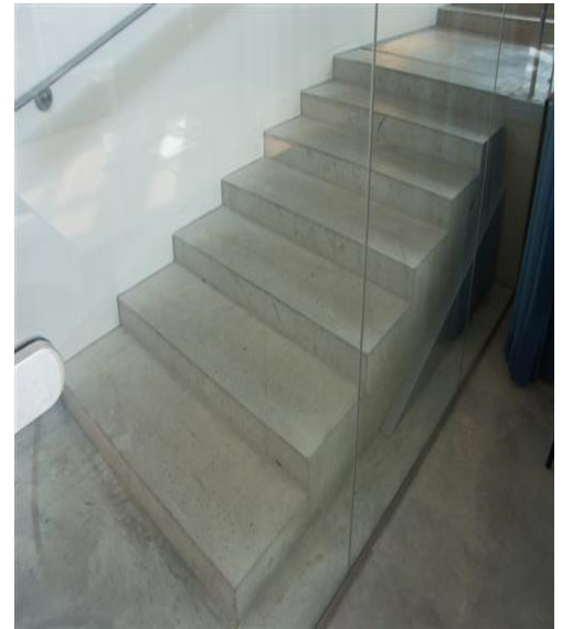
Figure 268: Marches d'escalier réalisés en béton fini lisse avec couches de peinture anti-poussière à base de résine époxydique.
