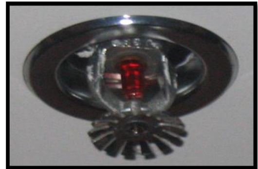
Figure 293:Le diffuseur d'extinction
