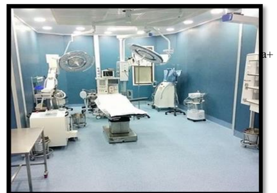
Figure 264: Bloc opératoire en PVC électro conducteur
