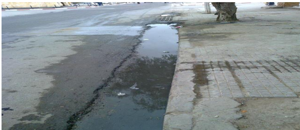
شكل رقم 07: يوضح حالة تدهور شبكة الصرف الصحي.
