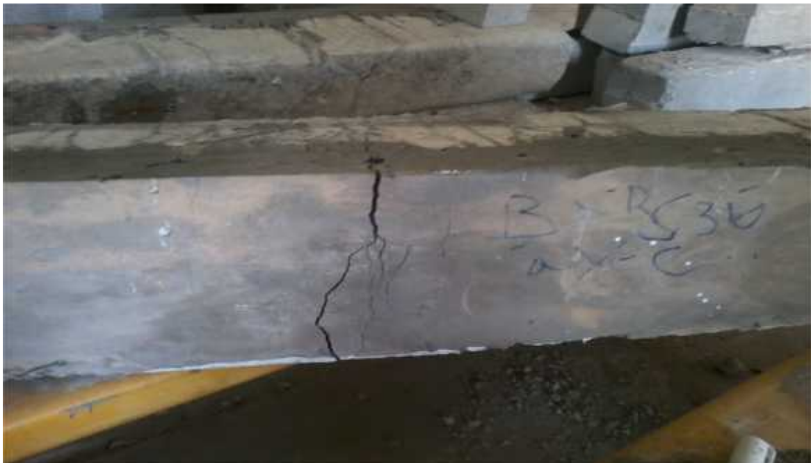
Photon°21 : de fissures de Flexion de poutre réparée au mortier adjuventé (séré B)
