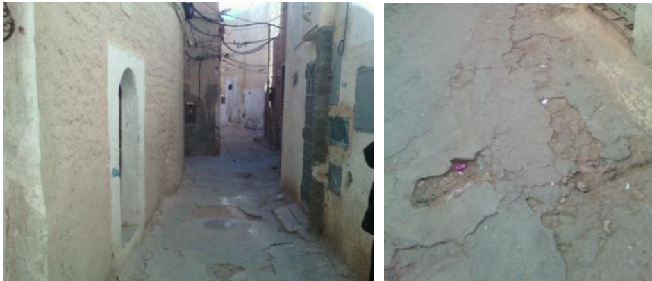
Figure 95: pavage dégradé. Pris par les étudiants
