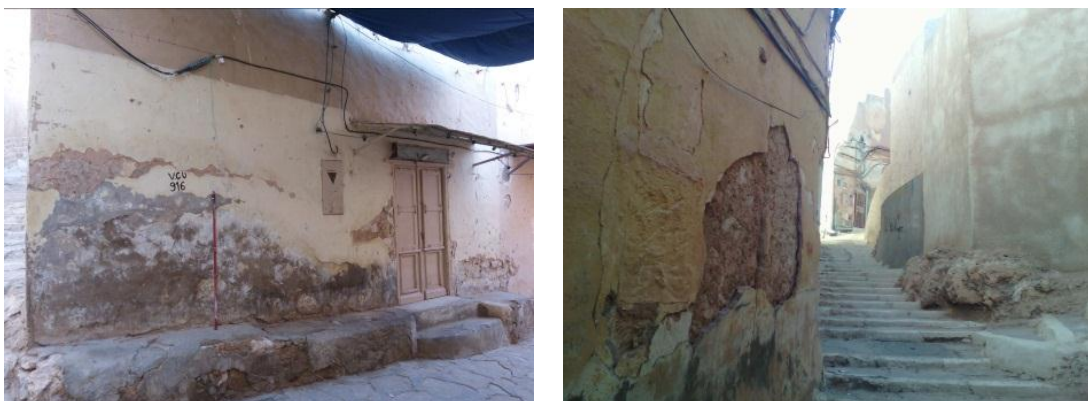
Figure 85: la dégradation de soubassement. Pris par les étudiants
