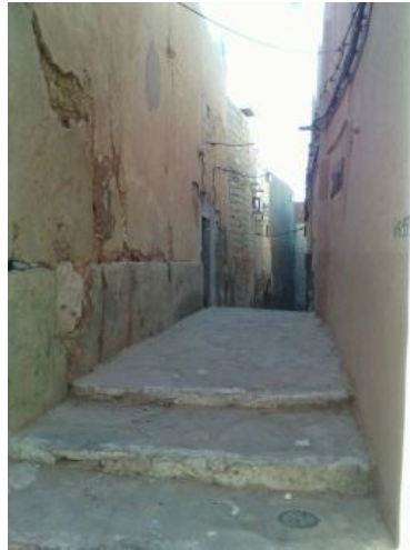
Figure 90: fissure inclinée. Pris par les étudiants
