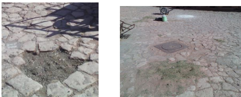
Figure 107: Dégradation du pavage. Pris par les étudiants
