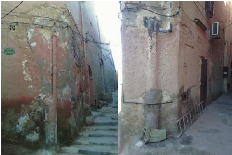
Figure 97: humidité sur la façade. Pris par les étudiants
