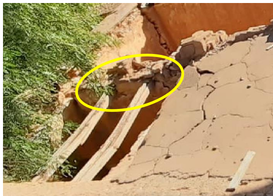
صورة رقم (3-7) الصورة توضح تلف بطرفي عارضة السقف
