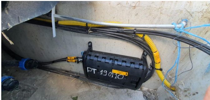
Figure I- 12 : PEP sous terrain (chambre)
