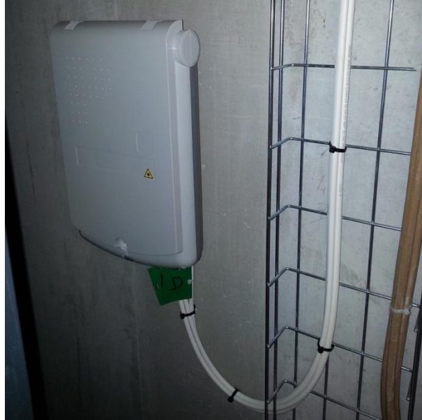
Figure I- 17 : Boitier pied de l'immeuble
