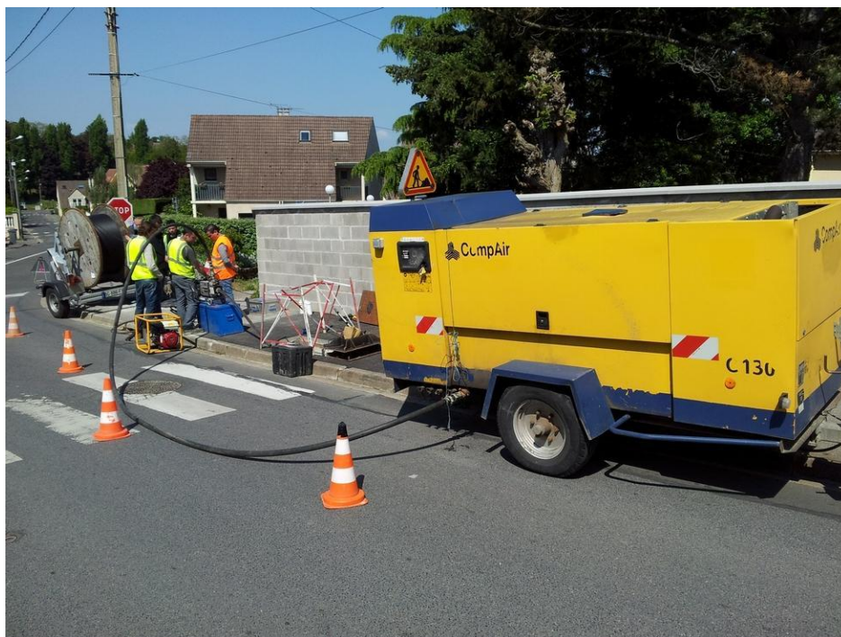
Figure II- 15 : Équipements de soufflage
