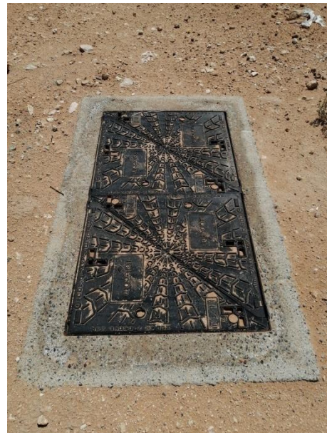
Figure III - 2 : Chambre K2C fermée
