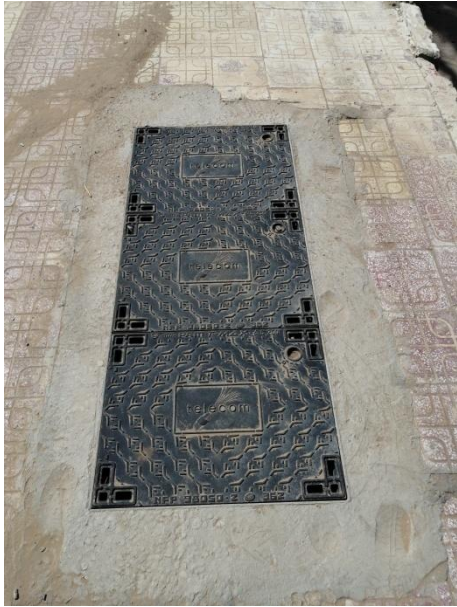
Figure III - 3 : Chambre L3T fermée
