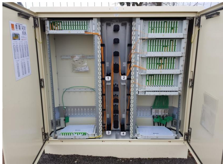
Figure I- 14 : Sous répartiteur optique
