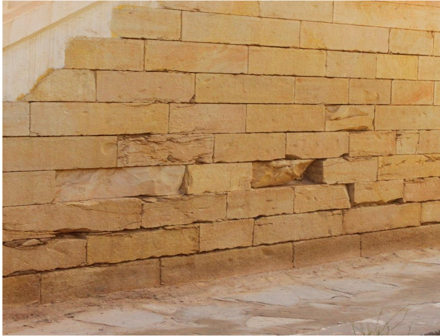
Fig IV.11: Dommages aux pierres de mur extérieur.
