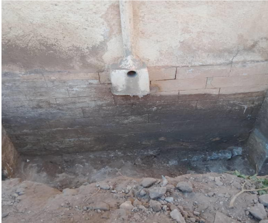
Fig IV.10 : Taches d'humidité à la base des murs extérieurs.
