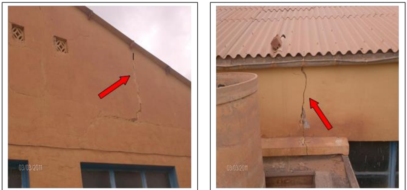
Fig IV.17 : Fissures en haut des façades.
