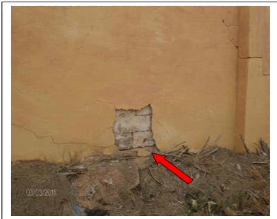
Fig IV.19 : Détérioration des enduits.
