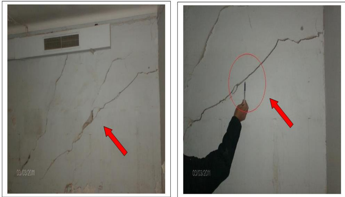
Fig IV.22 : Fissures de différentes natures sur les murs.
