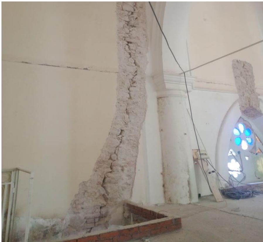
Fig IV.5 : Fissures semi-profondes et profondes.
