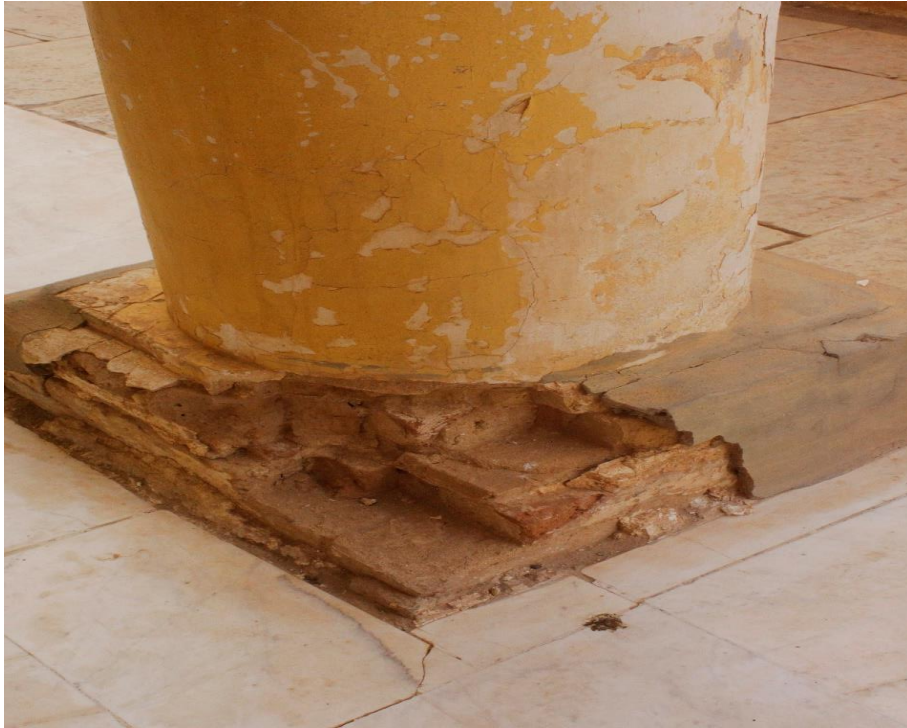
Fig IV.9 : Décollement de revêtement
