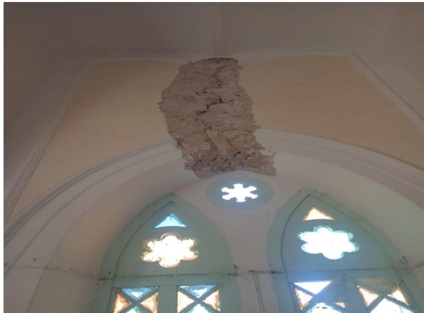
Fig IV.12 : Fissures au sommet des arcs des fenêtres.
