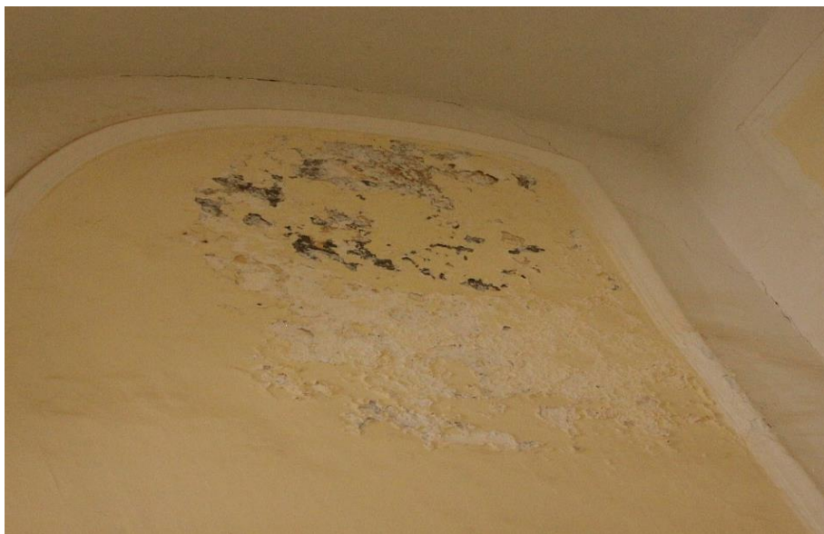
Fig IV.7 : Taches d'humidité dans la partie supérieure des murs
