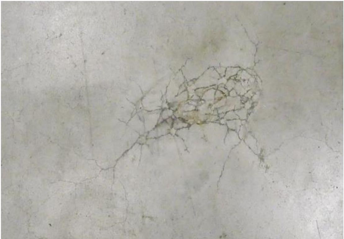
Fig II.2 : Délamination des dallages en béton
