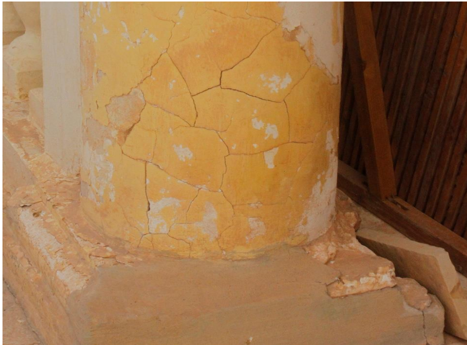
Fig IV.8 : Des fissures de faïençage ainsi que des décollements d'enduit
