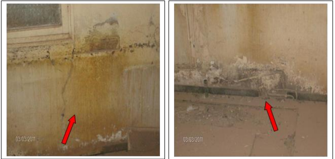
Fig IV.20 : Problèmes d'humidité et moisissures préoccupants.
