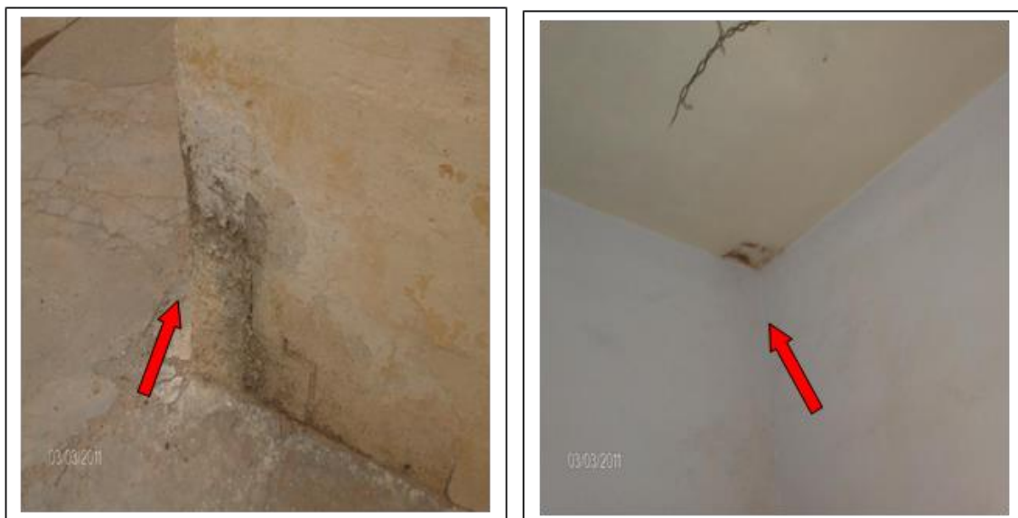
Fig IV.21 : Altérations graves au niveau des poteaux, et traces d'humidité sur le haut du mur et à l'angle du plafond.
