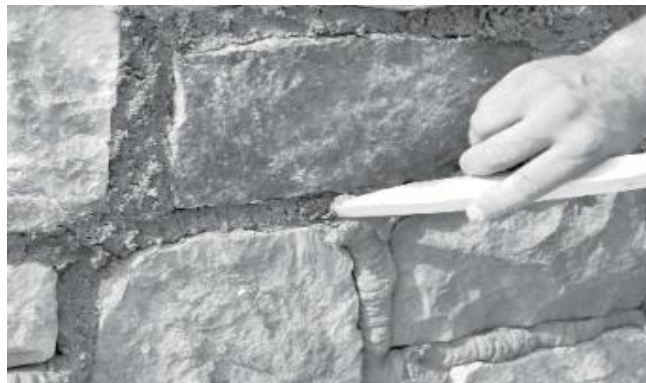
Fig III.8: Enfoncement de la pâte dans le joint en retirant l'excédent avec une baguette en bois. [Geopietra, 2020].
