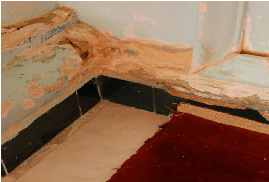
Fig IV.6: Traces d'humidité au pied des murs avec éclatement du revêtement.
