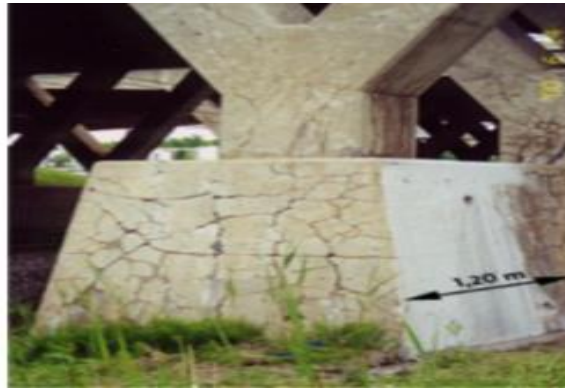
Figure II.7: Exemple de béton dégradé par l'alcali-réaction.
