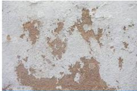
Figure II.2: Abrasion du béton.
