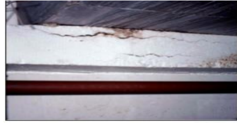
Poutre support de réservoir
