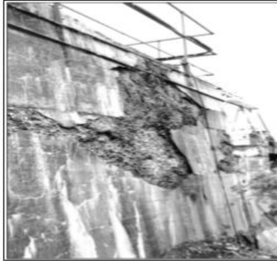
Figure II.6 : Exemple de dommages causé par le gel-dégel.
