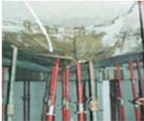
Figure II.4 : Fissuration et éclatement du béton sous charges trop importantes.
