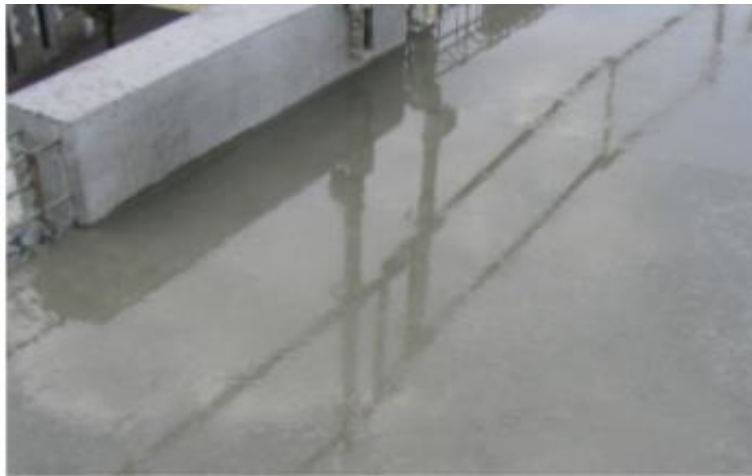
Figure II.5: Ressuage du béton après vibration.
