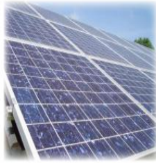
Énergie solaire - photovoltaïque
