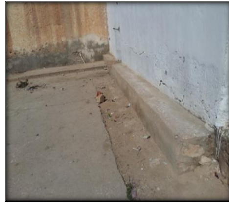
صورة رقم 111: توضح خروج الأملاح المصدر الطالب
