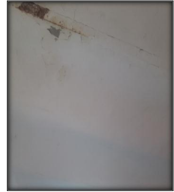
صورة رقم 119: سقوط التلبيس في سطح المسجد المصدر الطالب
