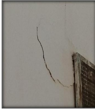
صورة رقم 117/توضح التشققات في المسجد المصدر الطالب
