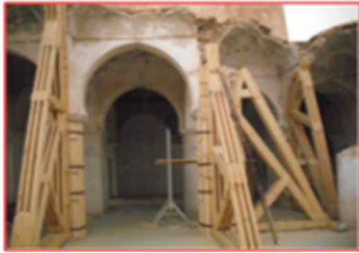
صورة رقم 21: المساند بالخشب للأقواس وللأعمدة المسجد سيدي حما لعروسي. المصدر: عن مكتب الدراسات المعمارية والمساعدة التقنية- خليبي عبد الحفيظ-ورقلة
