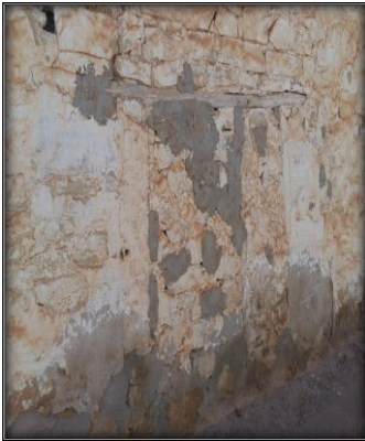
صورة رقم 115: توضح سقوط التلبس في المحازن المصدر الطالب
