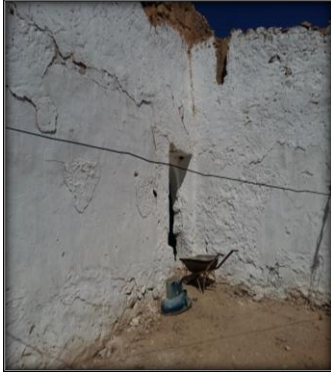
صورة رقم 118: توضح التشققات في غرف المشايخ المصدر الطالب
