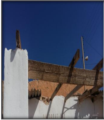
صورة رقم 121:سقوط سقف المصدر الطالب
