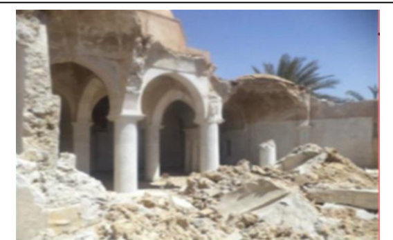
صورة رقم 18:تدهور الإطار الجنوبي من المسجد سيدنا حما لعروسي تحتاج الى تدابير طارئة
