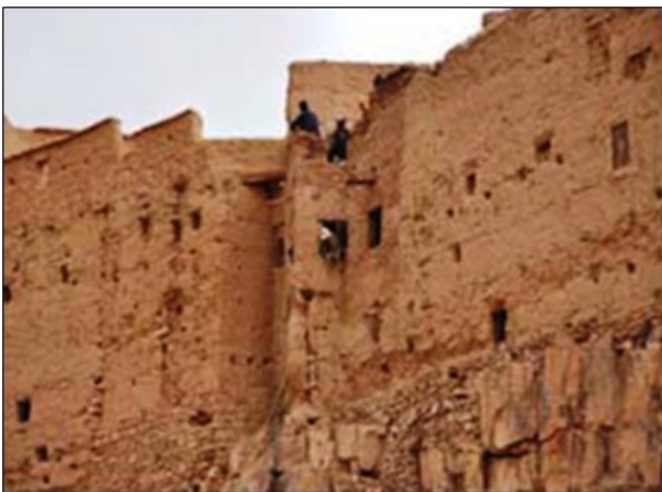
Photo II-30 : l'état de mur ksar Agadir Ouzrou [69]
