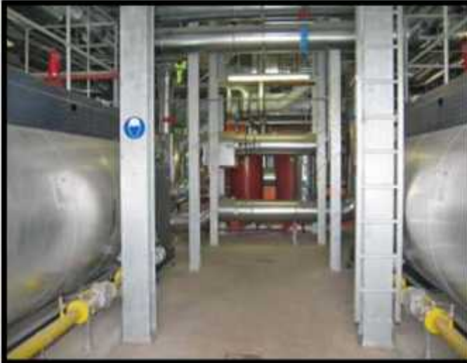
photo11 : un usine de Cogénération ;
